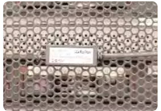
Exemple de capteur de température installé au niveau de l'arrivée d'air froid d'un rack de serveurs. Le capteur est connecté à une PDU intelligente (non représentée).
